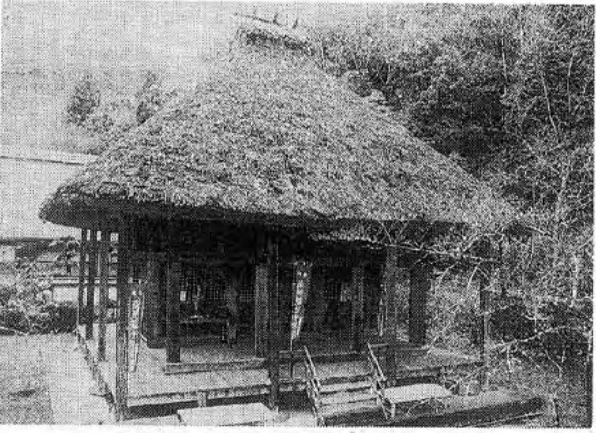
本堂の茅ぶき屋根も傷みが激しく、改修の必要がありそうだ
